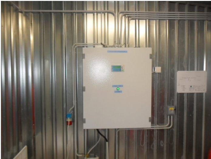
Joonis 5-8 Pargi puurkaevpumpla sisevaade (elektri-automaatikablokk)
