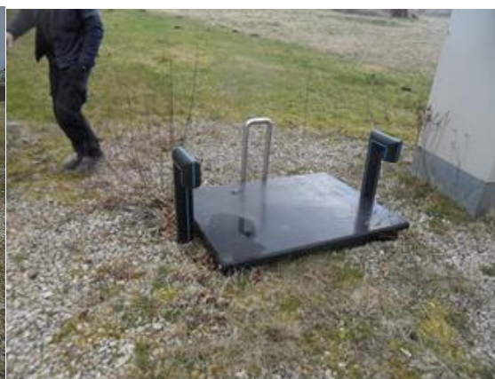
Joonis 6-2 Kalda reoveepumpla
