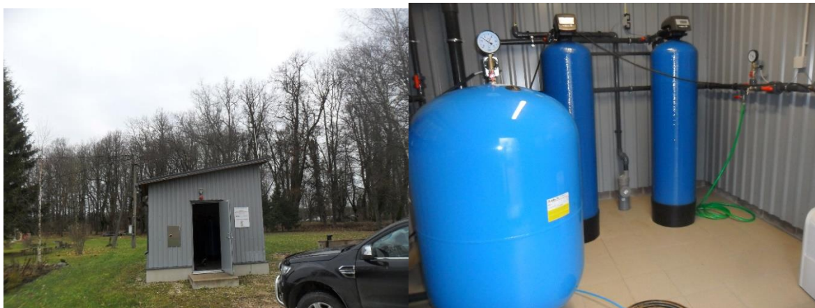
Joonis 5-20 Vesneri puurkaevupumpla välis- ja sisevaade
