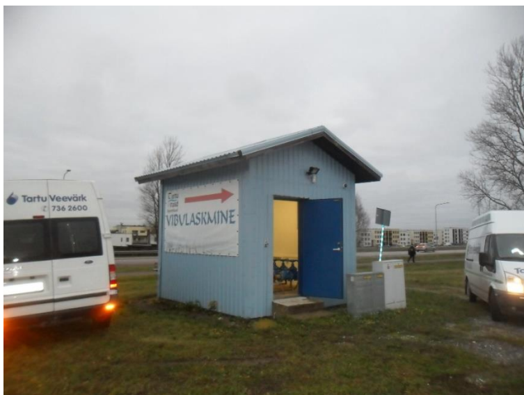
Joonis 5-6 Tila-Kõrveküla survetõstepumpla välisilme
