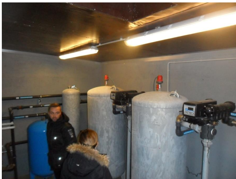
Joonis 5-14 Vasula veevarustuspumpla sisevaade (tagapool aeratsioonipaak, esiplaanil paarisfilter raua- ja mangaanieralduseks)
