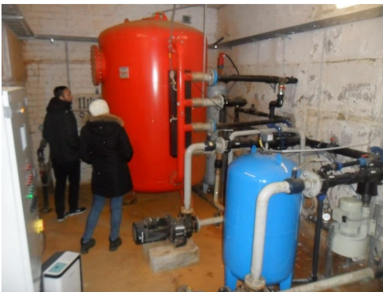
Joonis 5-10 Tabivere VTJ ja II-astme pumpla sisevaade (filter, II-astme pump)
