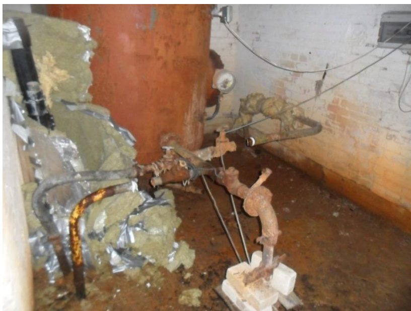
Joonis 5-2 Kõrveküla puurkaevpumpla nr 7253 sisevaade
