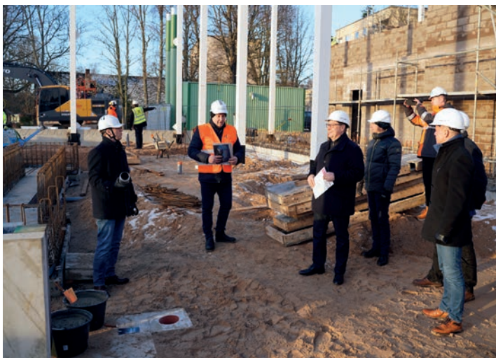
Möödunud aasta lõpus paigaldati Lähte uuele katlamajale nurgakivi. Vasakult Tartu Valla Halduse nõukogu esimees ja vallavolikogu aseesimees Martin Pedak, keskel Tartu Valla Halduse juhatuse liige Aigar Lepp, Tartu valla vallavanem Jarno Laur ja Tartu vallavolikogu esimees Vahur Poolak. Foto: Katrin Sisask.
